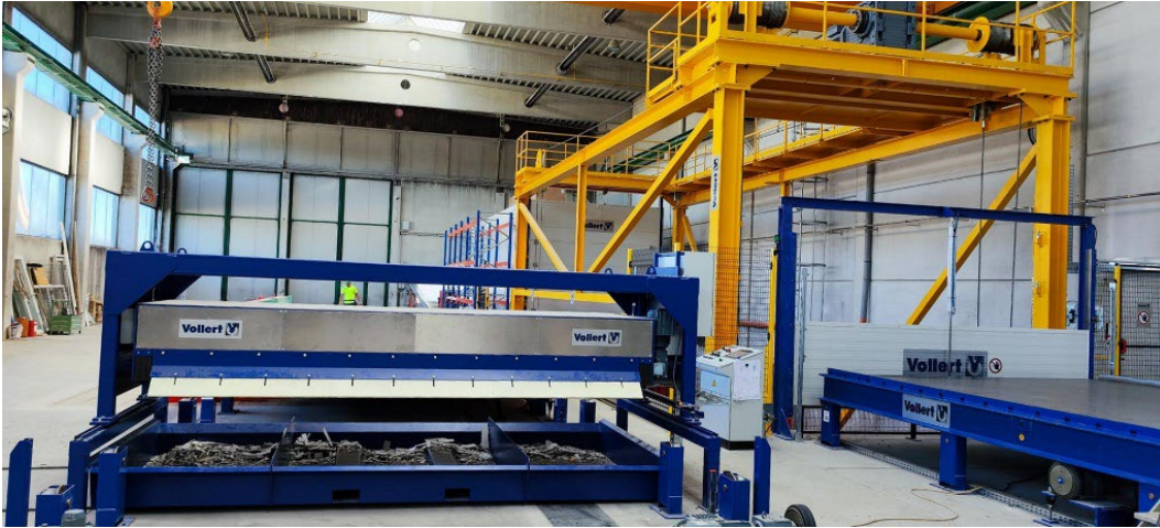
Bild 3: Die neue Maschinenteknik wurde optimal für die bestehenden Platzverhältnisse angepasst.
